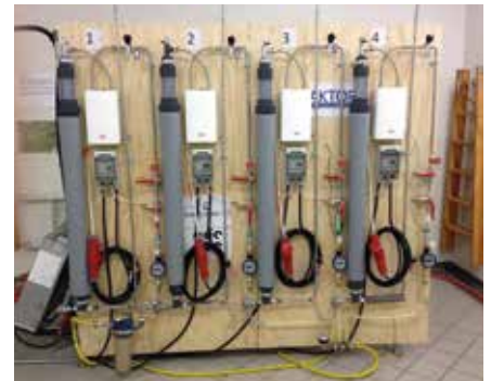
Figur 1 Forsøgsopstilling på Dalumværket med de 4 behandlingslinjer
